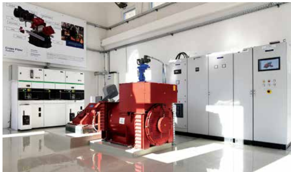
Реконструисана мХЕ „Подгор“
