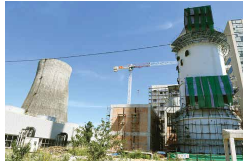
Еколошка реконструкција ТЕ Пљеваља
