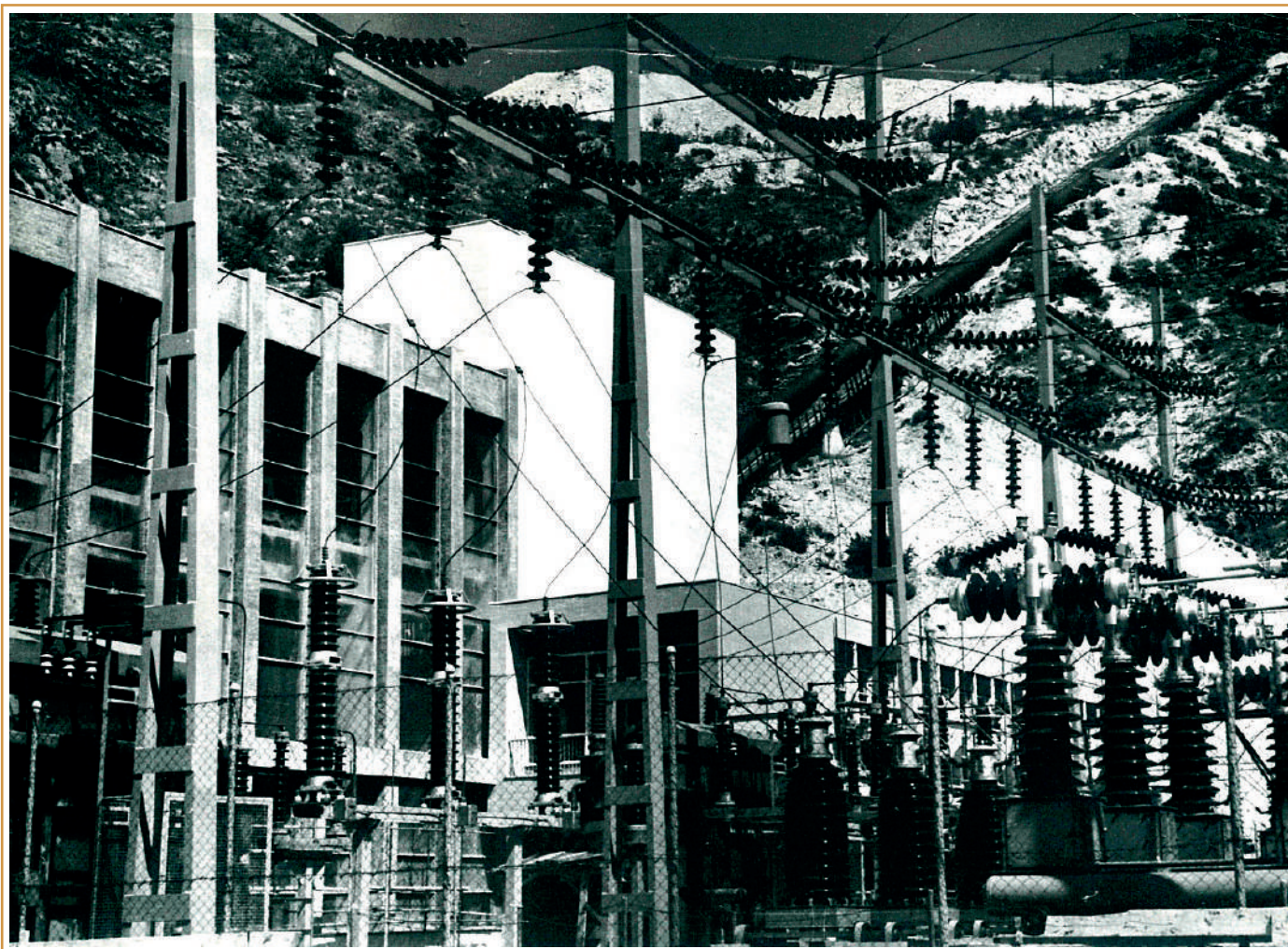
Razvodno postrojenje HE „Perućica“
